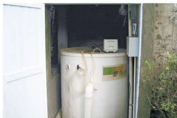
EN UNA CASA Así luce ya instalada
