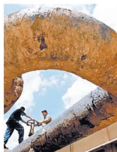
REINICIO Trabajadores intentan reiniciar las operaciones en una planta de bombeo de petróleo
